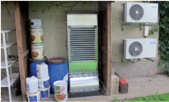
Hier ist die Außenluft-Ansaugung verbesserungswürdig.
