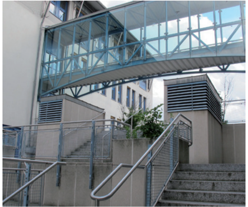
Hier ist Außenluft-Ansaugung vorbildlich gelöst.
